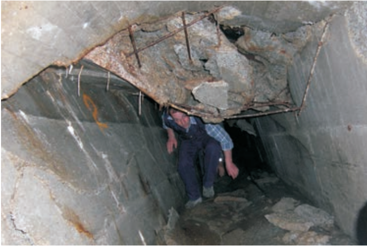
Die Sorge um den instabilen Tunnel begleitete den Neuwaal-Vorstand über viele Jahre. Im Bild der Waaler Heinrich Pircher (Eder) bei einer Kontrolle des Tunnels gleich hinter der Waalerhütte.
